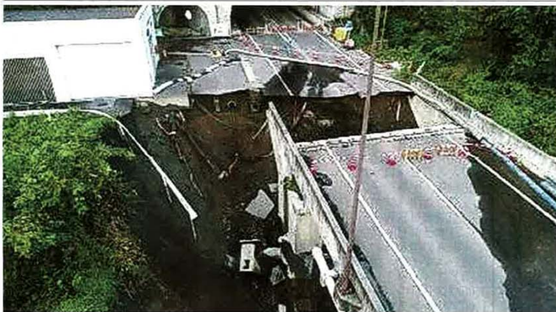
道路が落下した国道361号。道路下の地面がえぐれている＝22日、南箕輪村(県伊那建設事務所提供)
