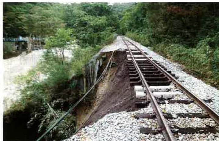
土台が崩落したJR小海線松原湖駅近くの線路=13日、JR東日本長野支社提供
