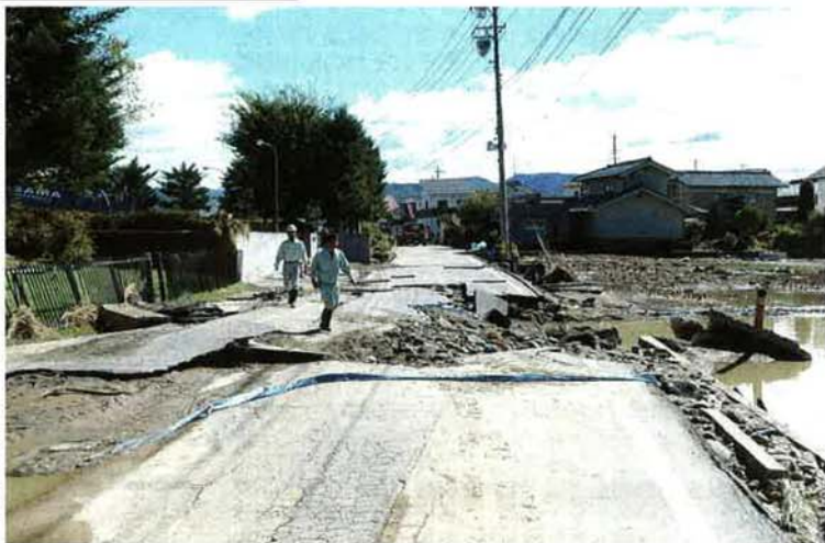
濁流で路盤が削られた杉の木地区の被災現場。左は下水道管理センター＝13日、佐久市中込
