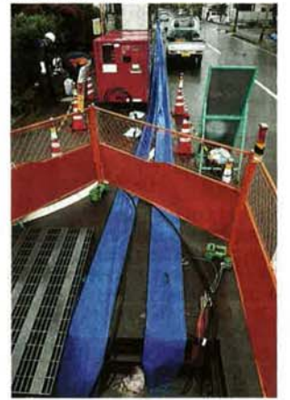
土地が低く、雨水がたまりやすい住宅街に設置された仮設ポンプ。雨水がたまる排水する=29日午後2時20分、長野市松代温泉
