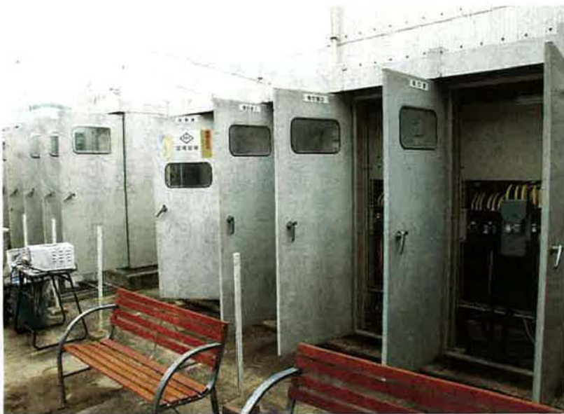
千曲川の氾濫で水没したカイン工業穂保工場の受電設備＝長野市穂保
