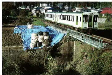
復旧工事が終わらず、ブルーシートで覆われたままの血川の決壊現場。その横を飯山線の列車が通り過ぎる＝2日午前8時1分、飯山市飯山
