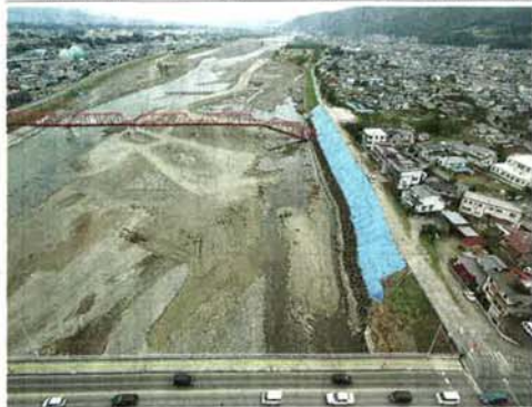
緊急復旧工事が完成した上田市の千曲川。別所線鉄橋が崩落した左岸(右側)をブロックやブルーシートで応急的に復旧し、川の流れを右岸(左側)に誘導した。北陸地方整備局が3日午後4時ごろドローンで撮影
