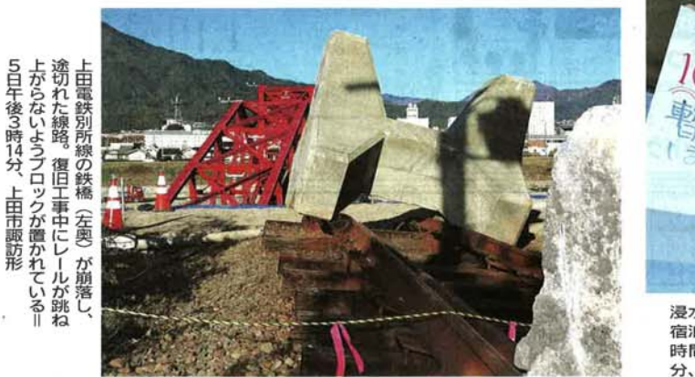
上田電鉄別所線の鉄橋(左奥)が崩落し、途切れた線路。復旧工事にシールが跳ね上がらないようロックが働いている＝5日午後3時14分、上田市飯形
