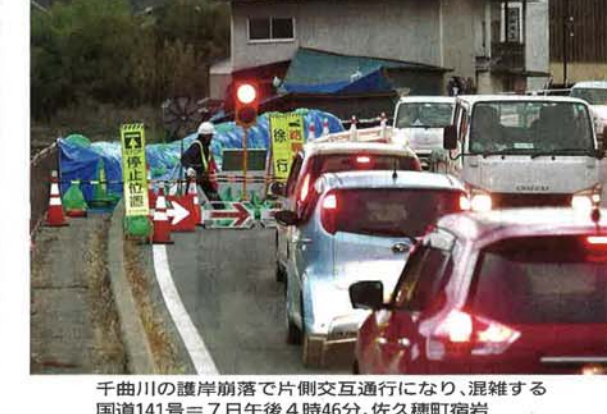
千曲川の護岸崩落で片側交互通行になり、混雑する国道141号＝7日午後4時46分、佐久穂町宿岩
