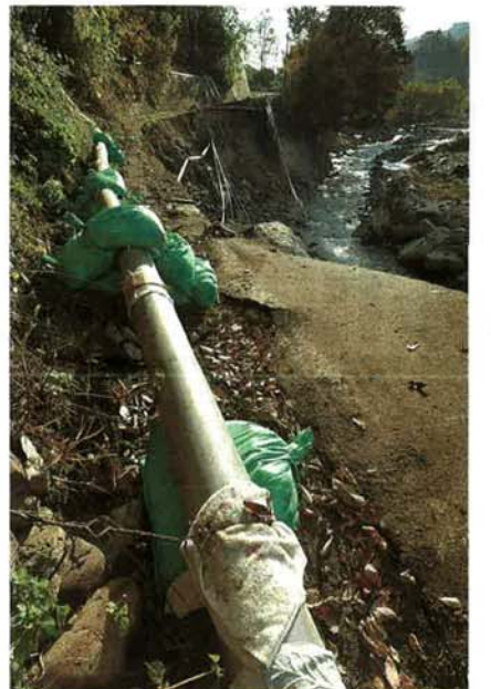
川沿いの道路崩落で水道も破損した現場。水道管が仮設されている＝7日午前7時57分、佐久穂町大日向
