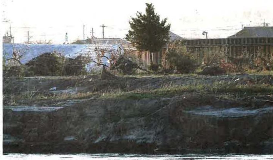
対岸から望む長野市穂保の千曲川堤防決壊箇所。仮堤防を囲う鋼材による「締切堤防」が河川敷に立っている。12日午後4時13分
