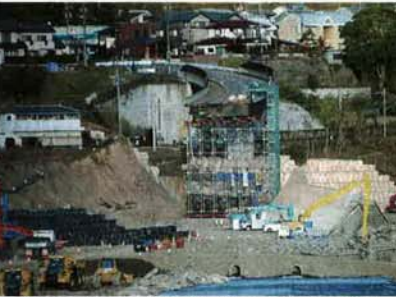
過去に少なくとも2回崩れている千曲川右岸。応急対策工事を終えた海野宿橋(中央)の下をしなの鉄道が通る。14日午後3時46分、東御市本海野
