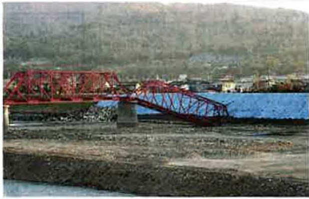
一部崩落した別所線の鉄橋。緊急復旧が終わった堤防にブルーシートがかかっている。16日午後4時12分、上田市
