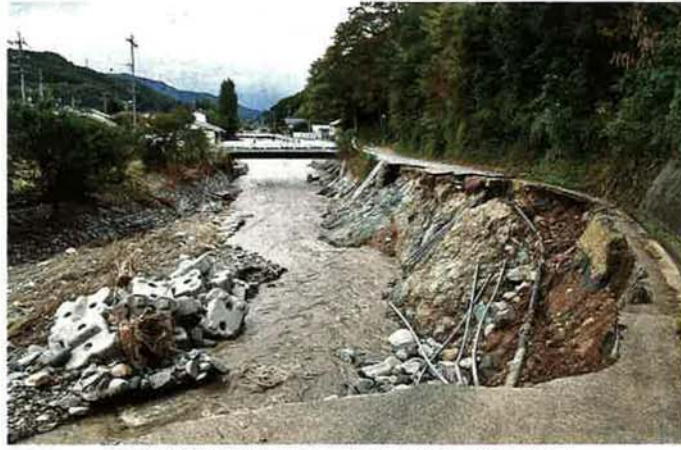
護岸や道路が崩落した抜井川＝10月17日
