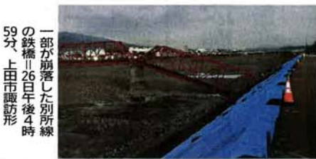
一部が崩落した別所線の鉄橋。26日午後4時59分、上田市撮影
