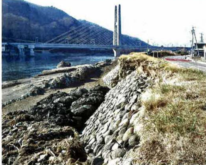
千曲川(左側)の増水や越水で堤防が削られている上田市国分の市道沿い
